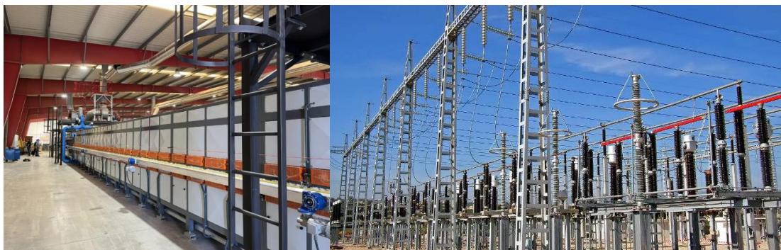
Imagen 3.2.2. Vista de un horno eléctrico (izquierda) y de la necesidad de ampliación en las subestaciones de suministro (derecha).
