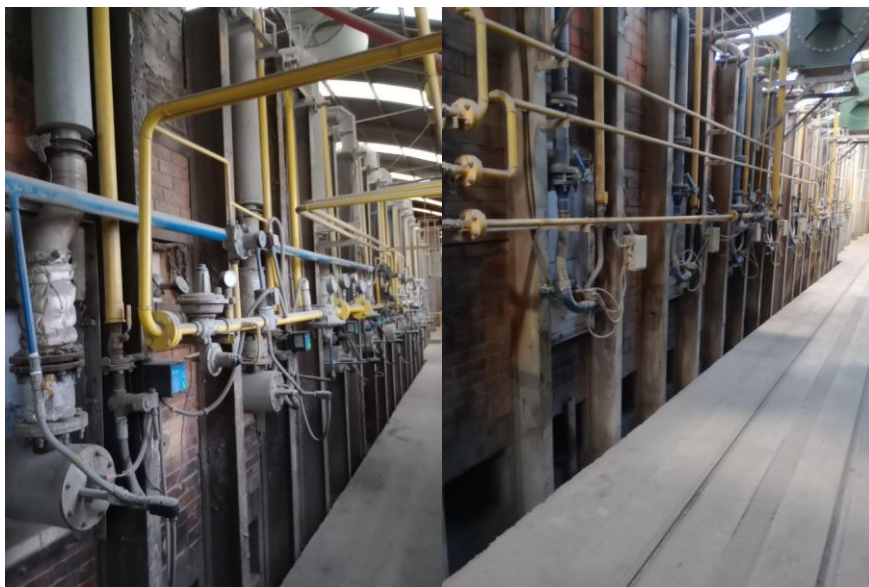
Imagen 1.2.3. Vista de los laterales de un horno túnel de Refractaria.
