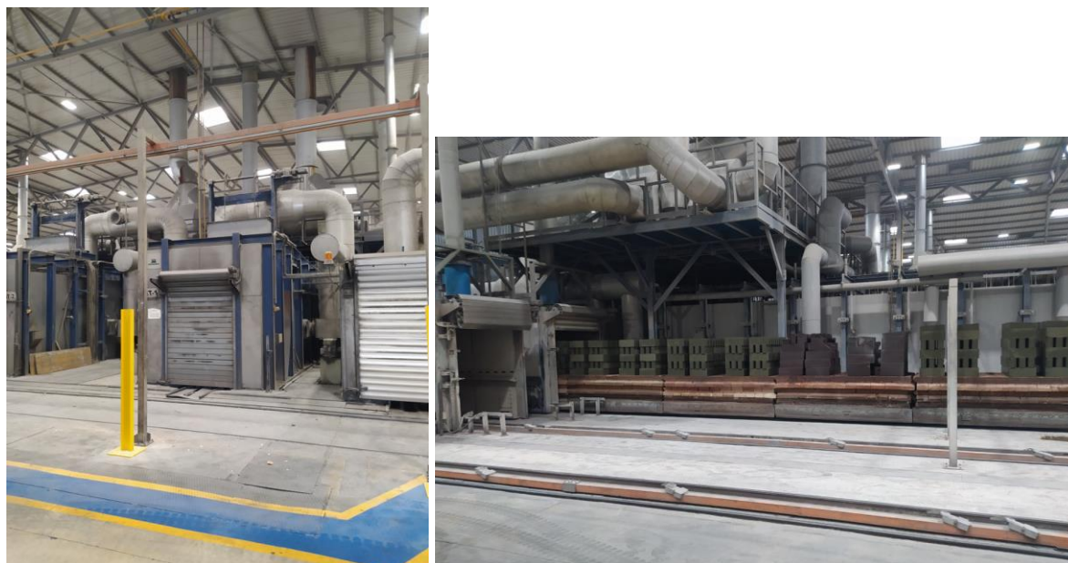
Imagen 2.3.1.1. Vista de la ubicación de las bocas de pre horno y horno (izquierda) y la entrada al pre horno con respecto al horno de donde se extrae la recuperación de calor (derecha).
