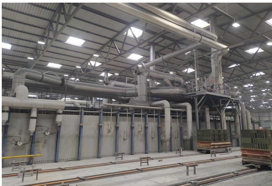
Imagen 1.2.1. Vista lateral de un horno túnel de la planta de Krosaki.
